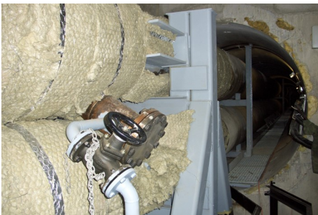
Fernwärmehauptleitung Walcherstraße, Wien 2.
